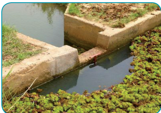
Photo : ouvrage de régulation sur un canal arroseur
